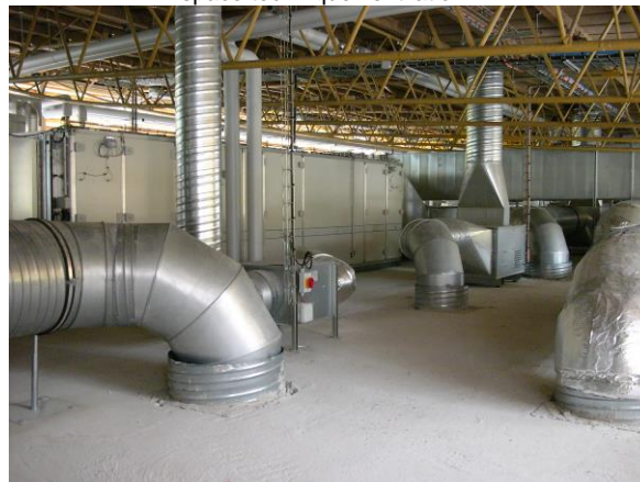
Espace technique ventilation
